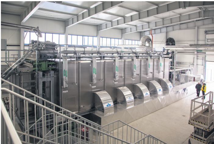
Nowoczesna suszarnia osadów w oczyszczalni ścieków w Opolu.
