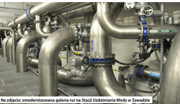
Na zdjęciu: zmodernizowana galeria rur na Stacji Uzdabtania Wody w Zawadzie
